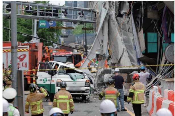
图为26日，在首尔西小门区西小门高架桥拆除现场，部分桥面板坍塌，消防人员正在进行事故善后处理。消防当局已发布一级响应，展开救援工作。【图片来源：NEWS1】
